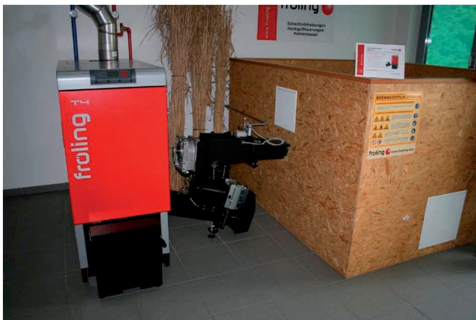
61. attēls. Neliela Fröling šķeldas apkures sistēma (24-50 kW jauda) ar apkures katlu (pa kreisi), kurināmā padeves sistēmu (vidū) un šķeldas uzglabāšanas tvertni (pa labi) (Avots: D. Rutz).
